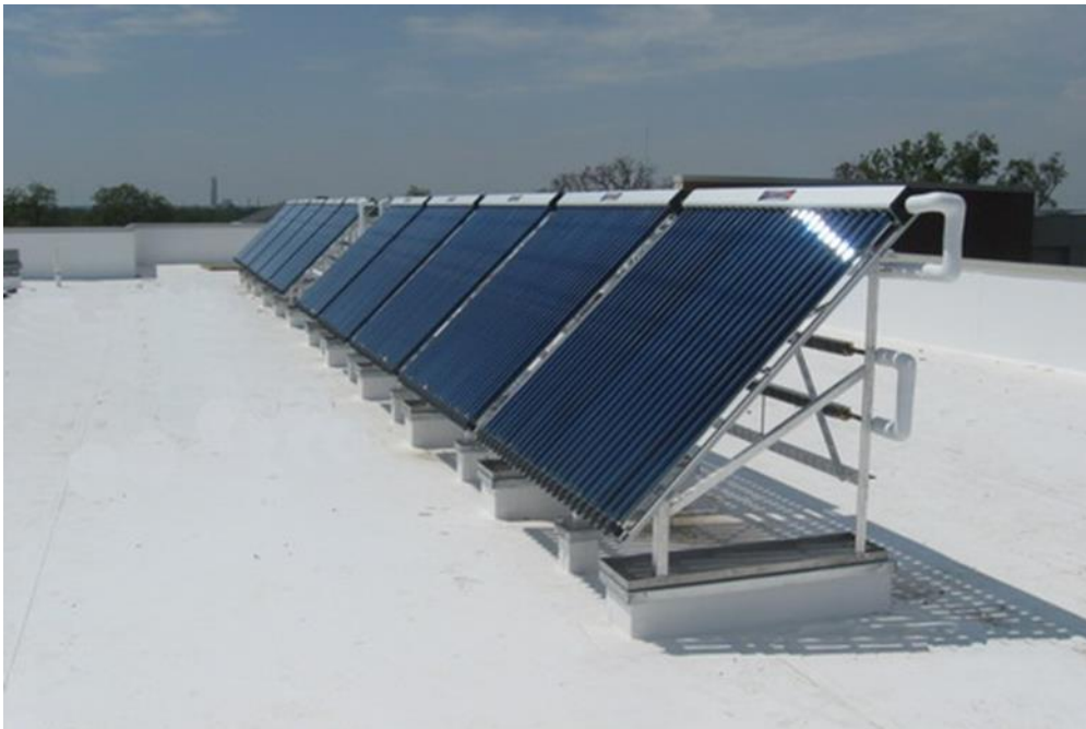
Слика 4-17 Соларни колектори инсталирани на крову ( http://www.solaramericasolutions.com/tag/solar-thermal-hot-water-systems/ )
