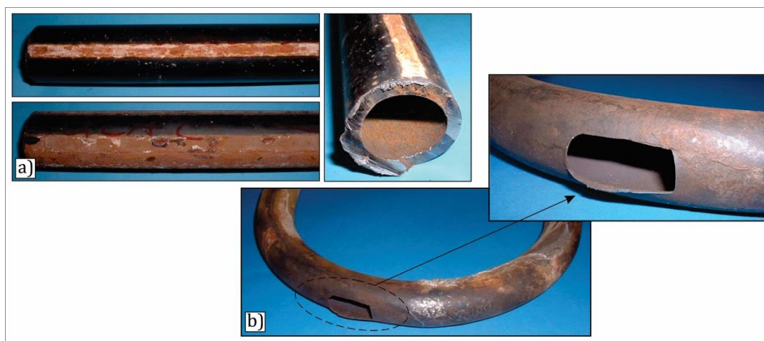
Slika 2.17. Erozijska oštećenja grejnih površina kotla TE postrojenja: a) pregrejač, b) ekonomajzer [27]
