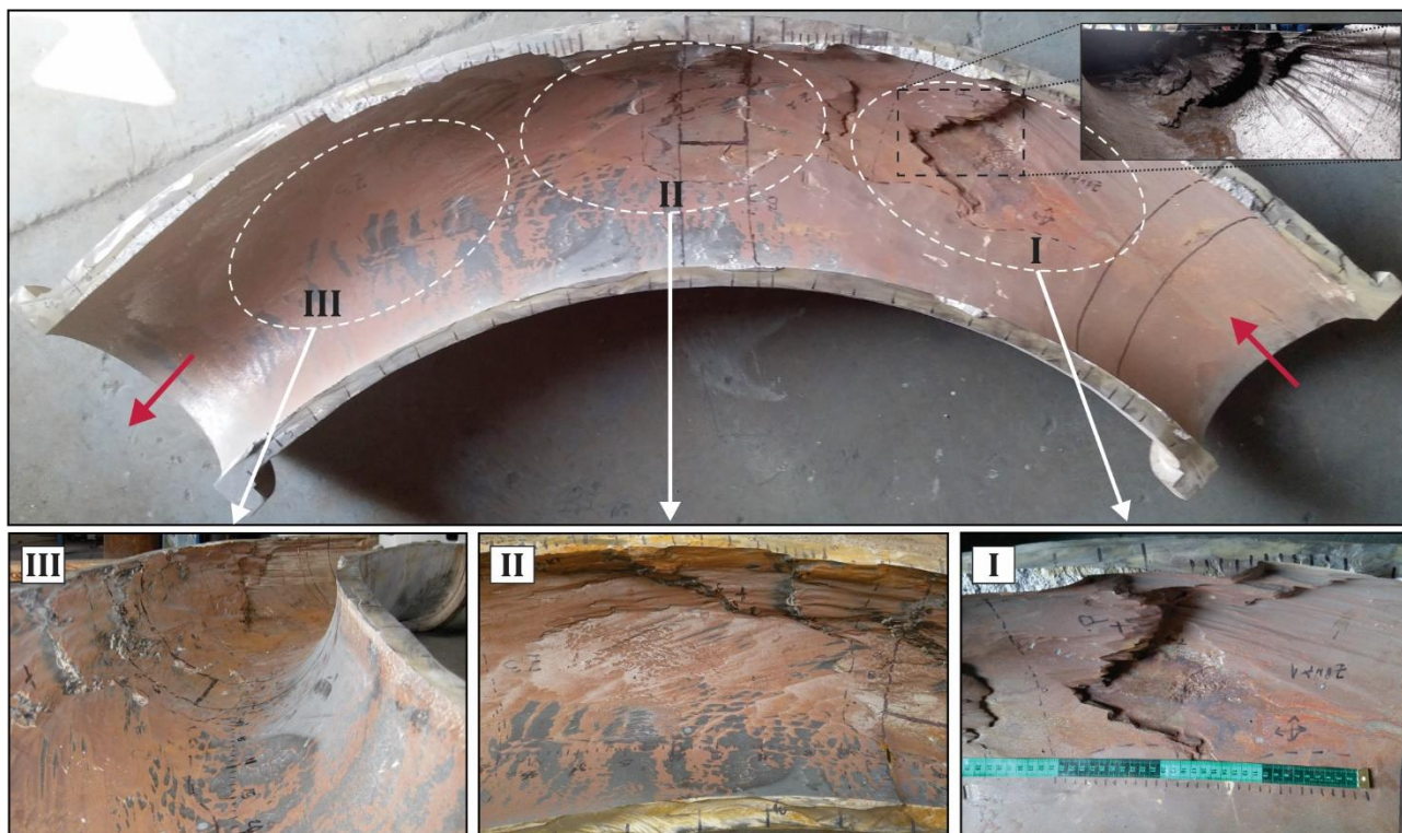
Slika 4.29. Cevni luk (in-situ): izgled unutrašnje površine nakon ~16000h rada
