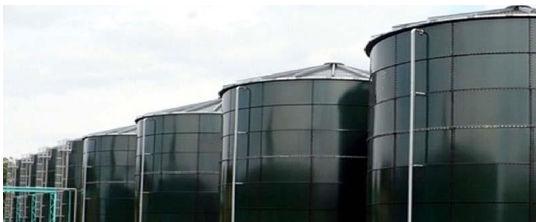
Slika 1.11. Kompleks rezervoara od čelika i stakla
