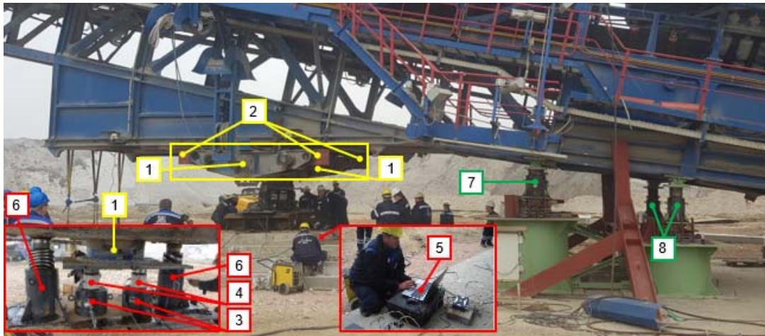
Слика 6. Мерење оптерећења ослоних колица изазваног тежинама пријемног транспортера и међутранспортера: 1-четворочковна колица обртног стола; 2-алат за фиксирање четворочковних колица; 3-мерни хидроцилиндри; 4-мерне ћелије; 5-вишеканални уређај за аквизицију података; 6,7,8-хидроцилиндри за привремено ослањање пријемног транспортера и међутранспортера.
