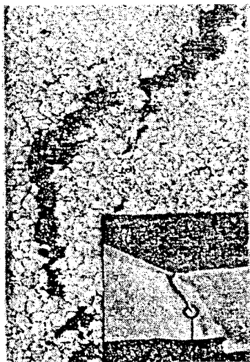
Slika 4. Interkristalni karakter prsline u zavarenom spoju parovoda izrađenog od Cr-Mo-V čelika
