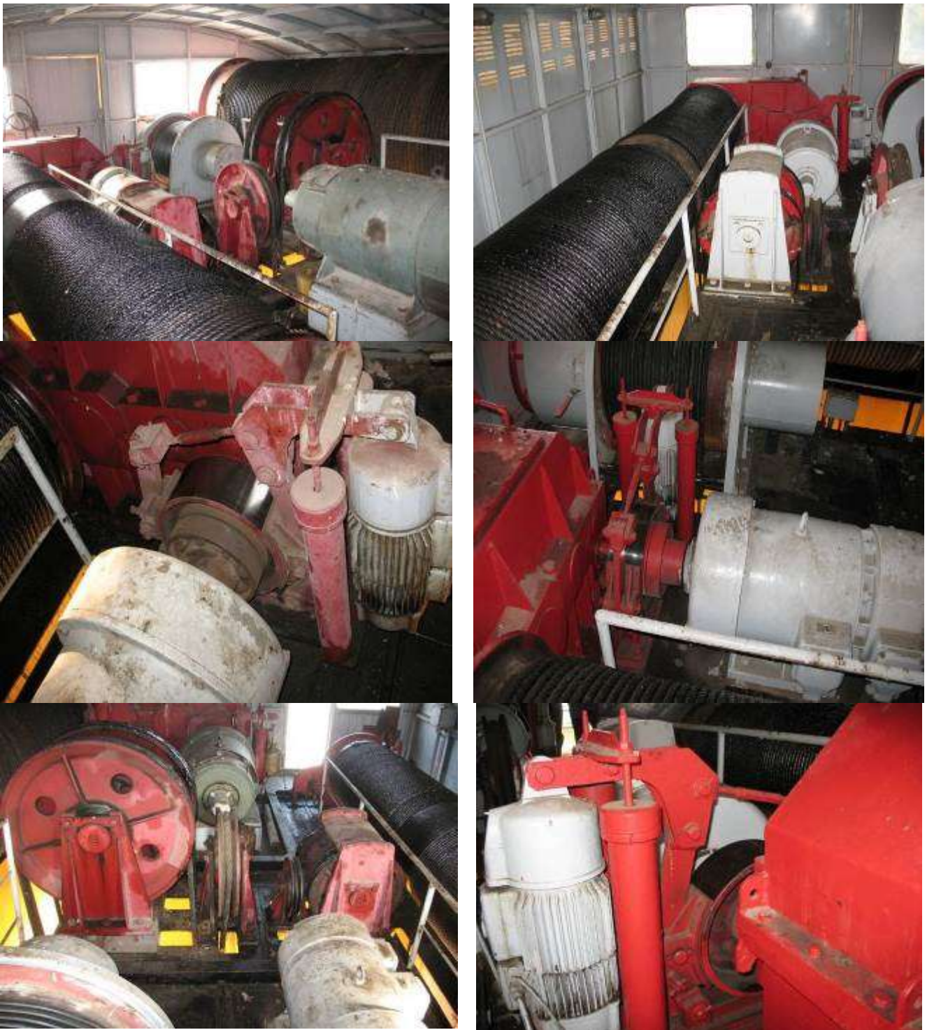
Slika 4.1.2.1 Stanje karakterističnih elemenata mehanizama pomoćnog dizanja obe portalne dizalice
