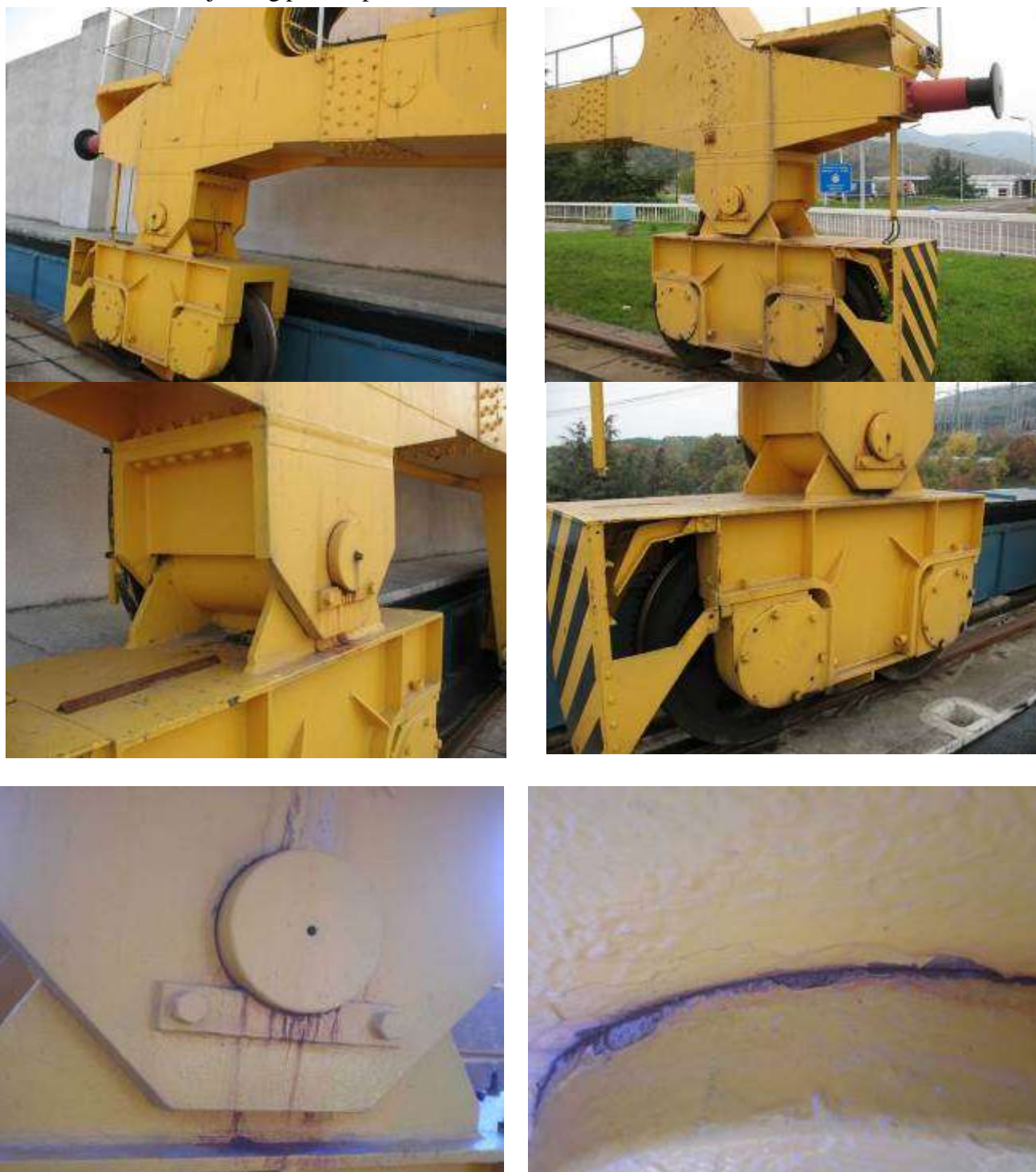
Slika 4.1.8.1 Stanje konstrukcije sklopa veze nogu portala i konstrukcije mehanizama vožnje dizalica
