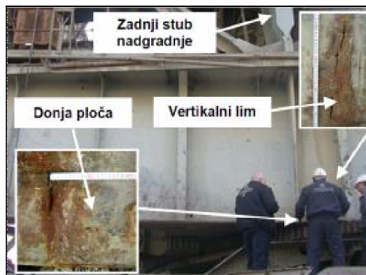
Slika 16 – Lokacije i izgled pukotina donje ploče i vertikalnog lima obrtne platforme – pogled spolja [5]
