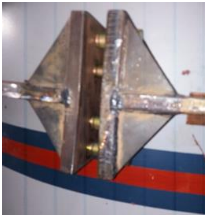
Slika 41. b) Specijalno dizajnersko rešenje za SP 970: ukrutni prsten oko lokacije defekta 5.6- stezni alat
