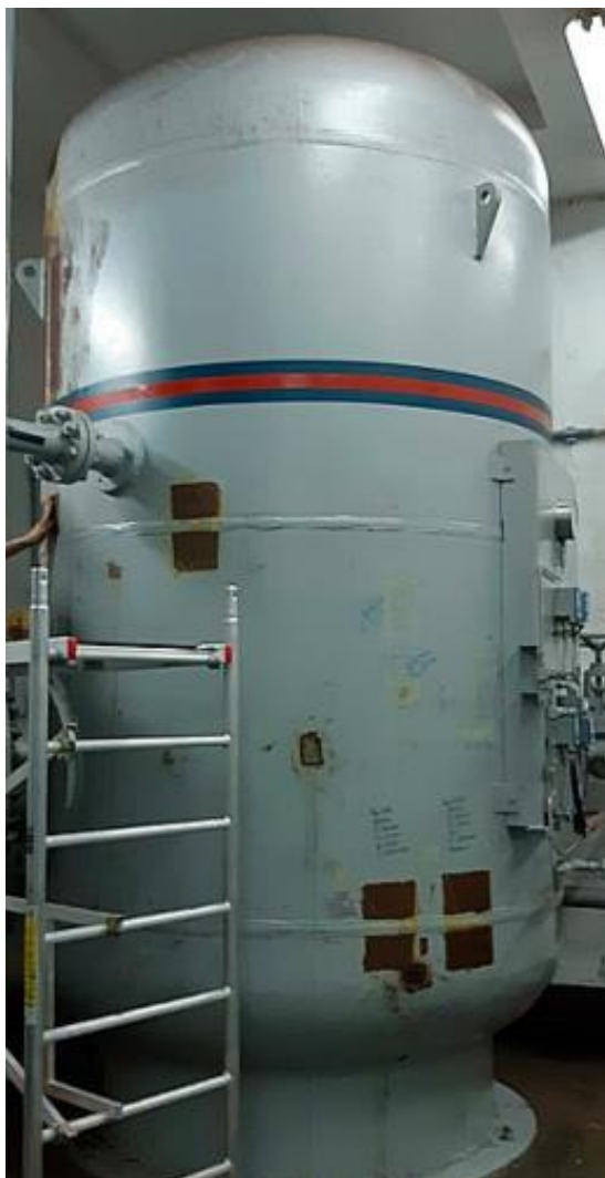
Slika 4. Sud pod pritiskom pre reparacije
