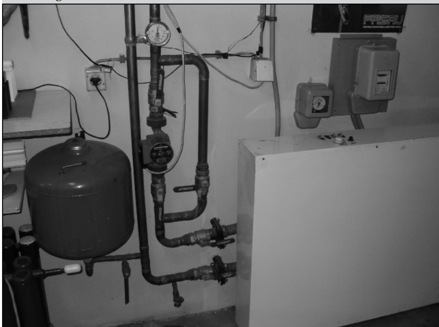
Slika 3 Grejna instalacija sa mernom opremom instaliranoj na kotlu u mernoj zgradi
