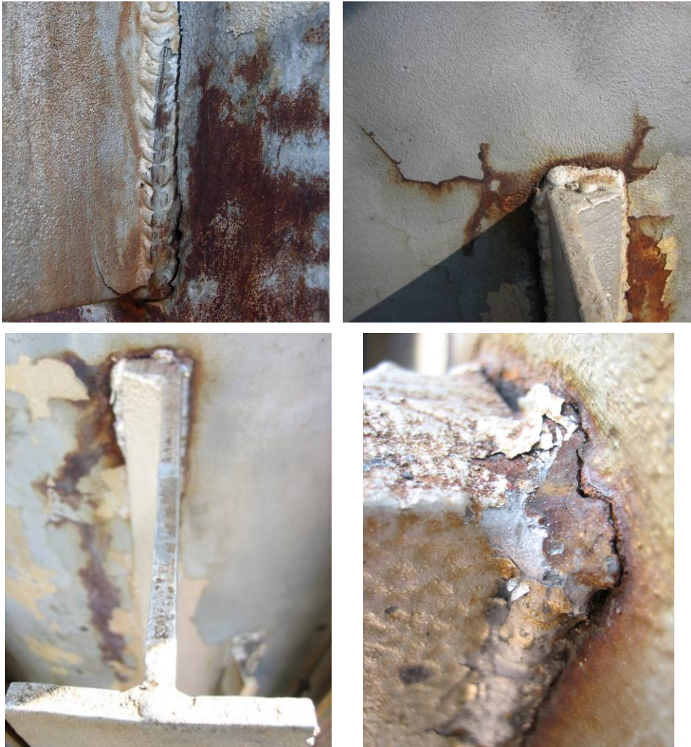
Slika 3. –Oštećenja plašta dimnjaka na mestu spojeva sa elementima ojačanja
