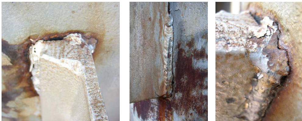
Slika 1. Oštećenja dimnjaka na mestima spojeva rebara sa plaštom
