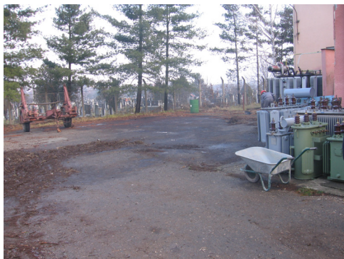
Slika 1. Dvorište trafostanice Zaječar 2 sa površinom kontaminiranom transformatorskim uljem
