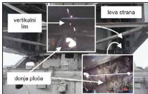
Slika 20. Lokacije i izgled pukotina donje ploče i vertikalnog lima obrtne platforme – iznutra
