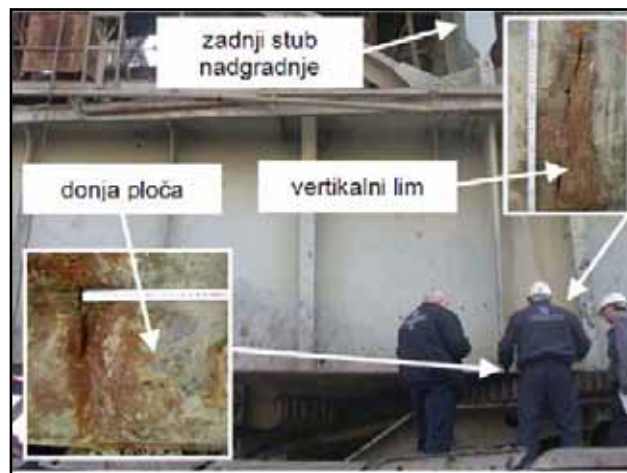
Slika 19. Lokacije i izgled pukotina donje ploče i vertikalnog lima obrtne platforme – spolja [3]
